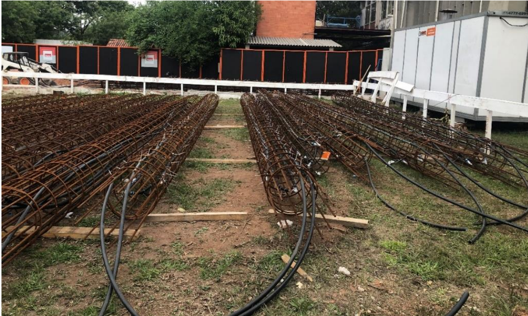
Foto 1: Tubos trocadores de calor instalados nas armaduras das estacas hélice contínua do CICS.
